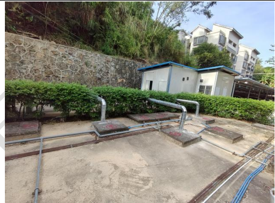
埋地式污水处理设施
