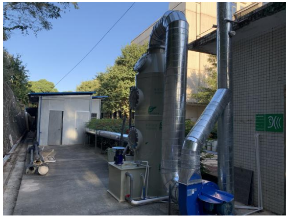
“生物除臭”废气处理设施
