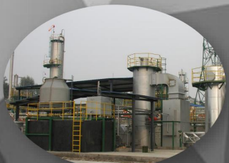
污泥干化焚烧
