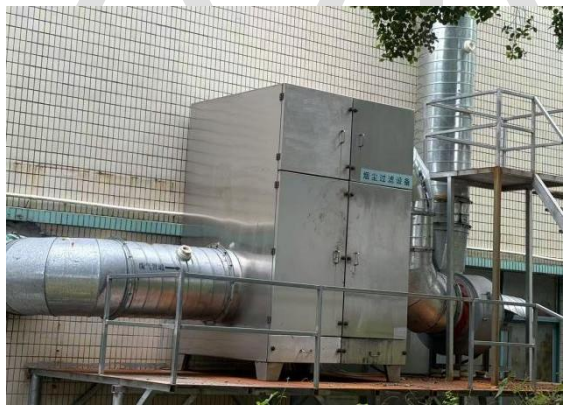
废气处理设施“烟尘过滤器”
