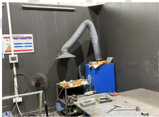
废气处理设施“移动式烟尘净化装置”
